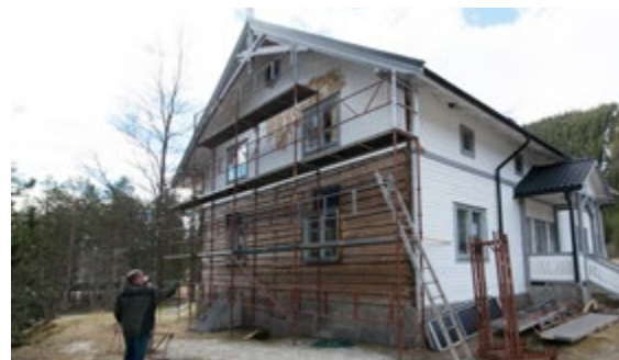
De opprinnelige vindusåpningene kom frem da kledningen på østveggen ble fjernet. Takhøyden blir satt tilbake til den opprinnelige på rundt 2,8 meter.
