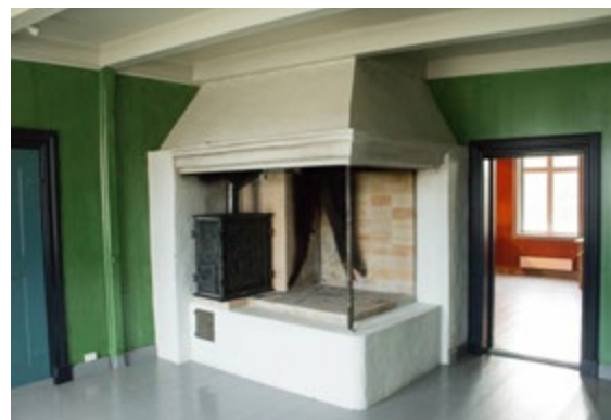
Det gamle kjøkkenet med jernovn fra 1680 skal få bedre isolasjon under gulvet. Foto: Ovf
