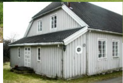
Eidanger prestegård hadde stått ubebodd over lengre tid, og det var stort behov for maling og utbedring av skader
